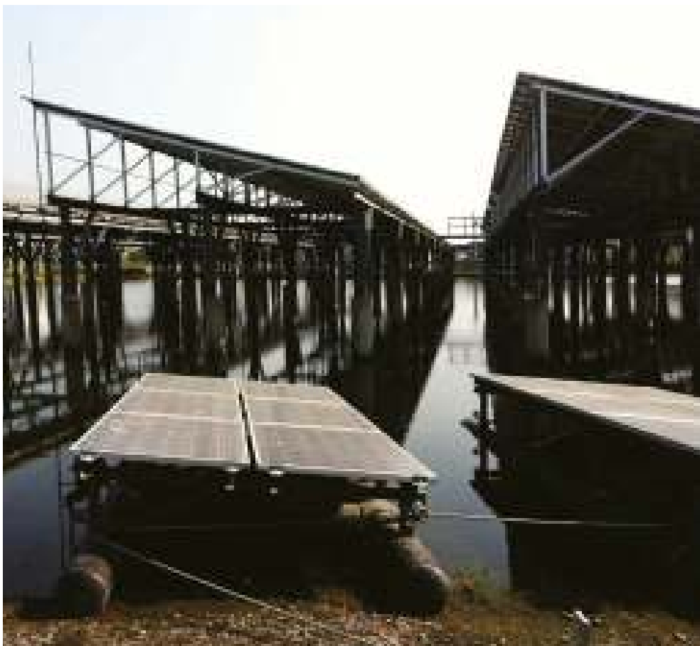
魚塢上的高架式與浮動式太陽能光電系統。
