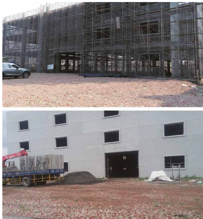
位於彰化縣鹿港鎮永安段222、223號農地的一處新增建工廠，是多個民間團體關注「新增建違章工廠即報即拆」承諾的指標。上圖為2017年3月2日拍攝，下圖則為8月2日拍攝。（攝影／地球公民基金會提供）
